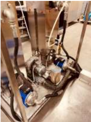
Vue des système de pompe renforcée avec filtration
